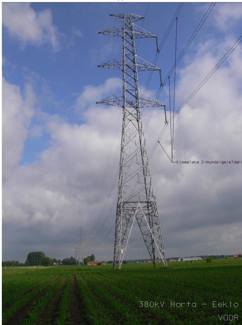
Figuur 13: Bestaande bovengrondse 380 kV- hoogspanningsverbinding met één draadstel
